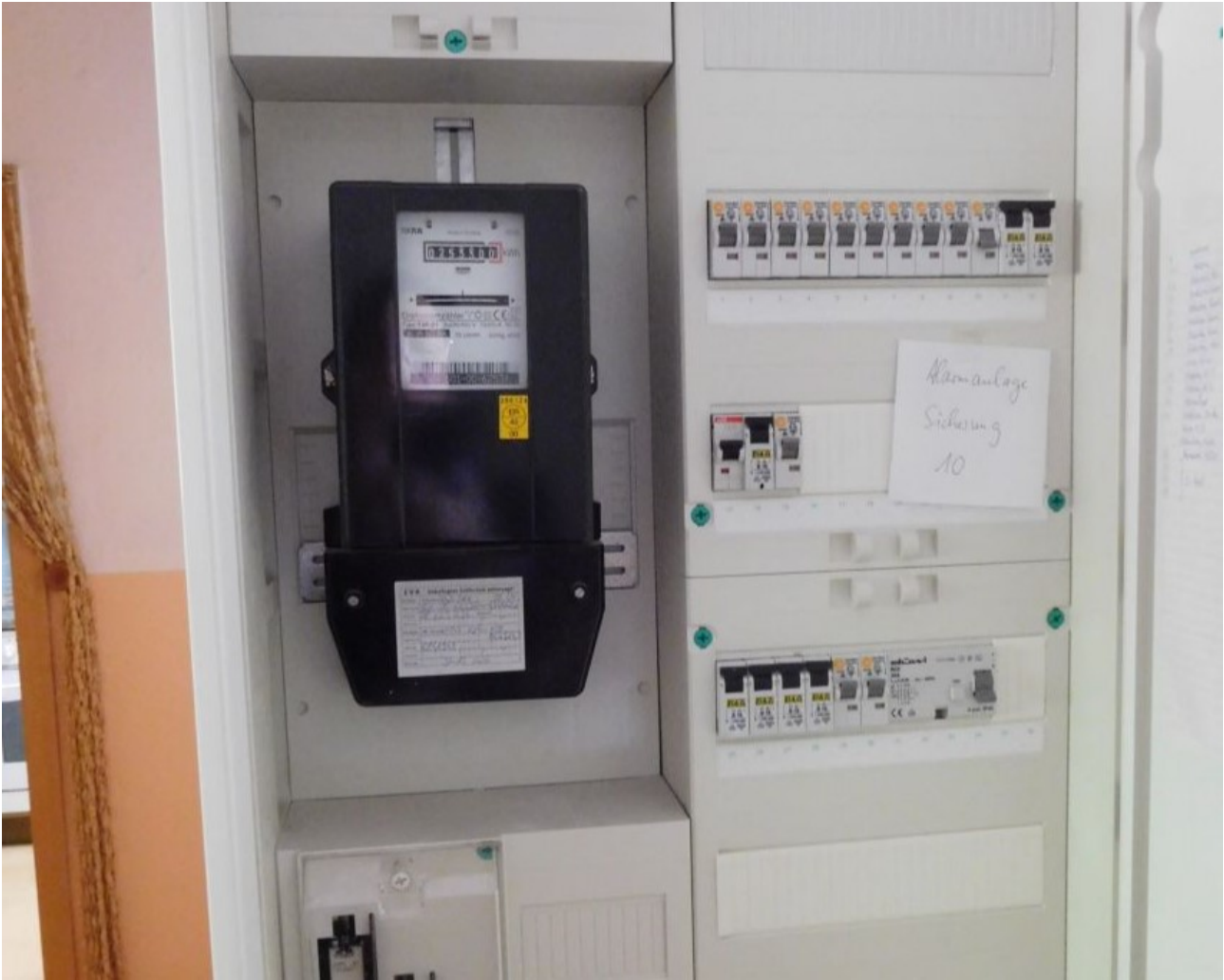
Sicherungs-, Zählerkasten (Strom)
